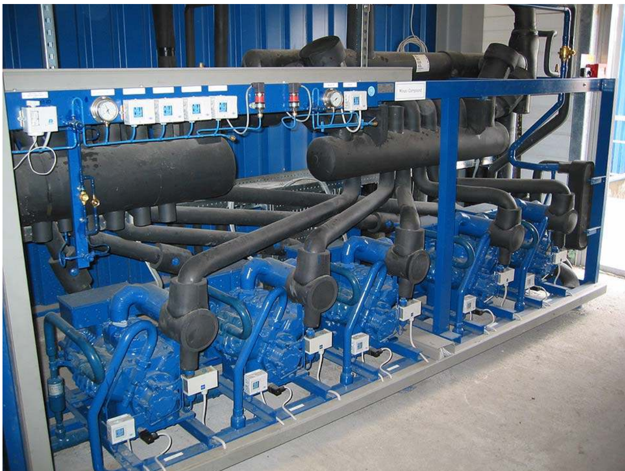
Низкотемпературная централь фирмы Linde с двухступенчатыми компрессорами Битцер S6F-30.2
